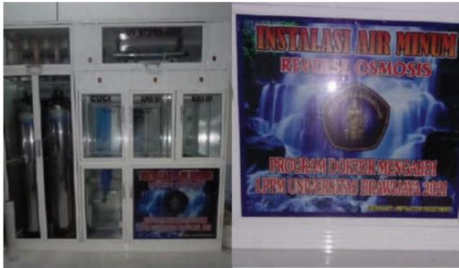
Rak Sistem Pengolahan Air Minum
